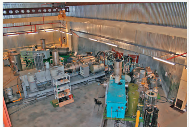
Рентгенографический комплекс на базе трех синхронно работающих ускорителей электронов. Главный зал
