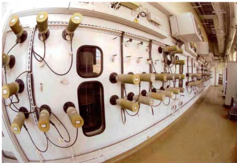
Шкаф управления установки разделения изотопов водорода
