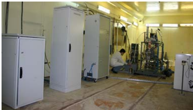
Рис. 1. Основное оборудование ускорителя ЛУ-8-2 в рабочем помещении: 1 – измерительная стойка; 2 – силовая стойка; 3 – модуляторный шкаф; 4 – блок импульсного трансформатора; 5 – система водяного охлаждения; 6 – излучающий модуль;
