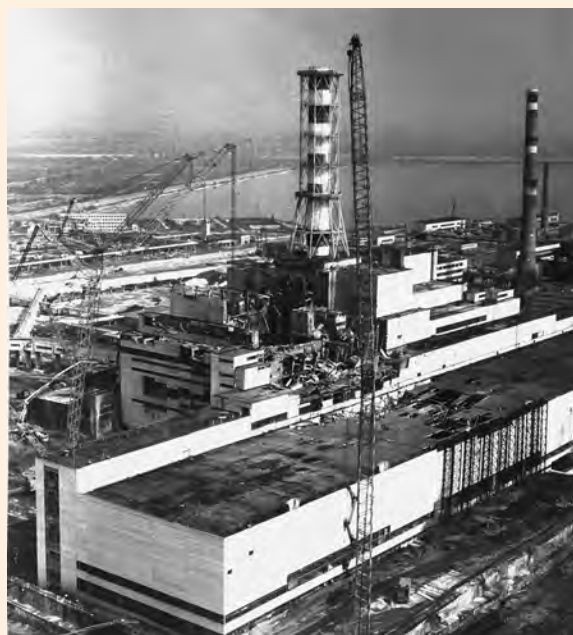
Крыша машзала, поврежденная при сбросе мешков с песком
