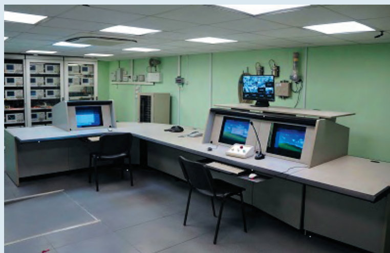
Пульт управления установкой
