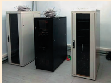
Телекоммуникационные шкафы с оборудованием
