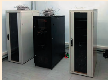
Телекоммуникационные шкафы с оборудованием
