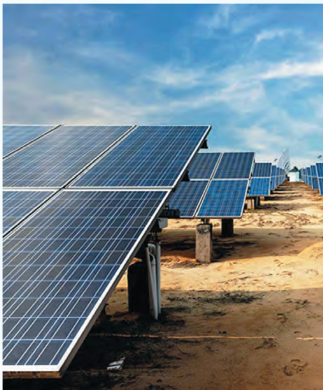
Характерная картина установленных панелей солнечной электростанции
