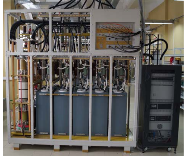
Рис. 1. Общий вид модуля конденсаторной батареи
