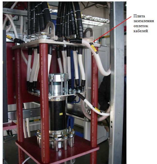
Рис. 6. Стойка основного коммутатора. Место заземления нагрузочных кабелей разрядных контуров ВБ модуля
