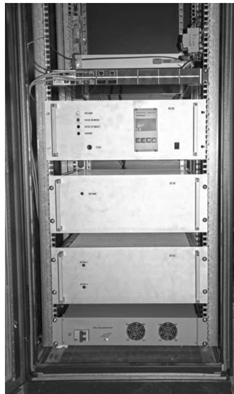
Рис. 2. Внешний вид стойки управления
