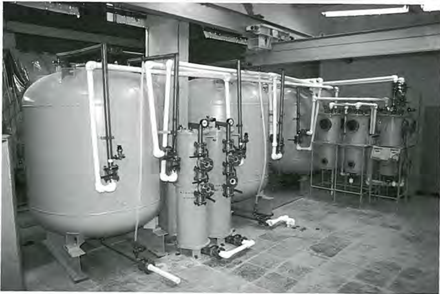
Рис. 10. Установка водоподготовки ускорителя
