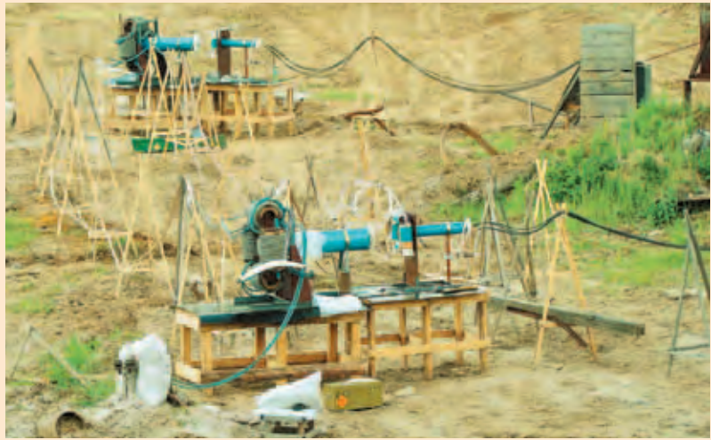
Источник энергии, смонтированный на испытательном полигоне
